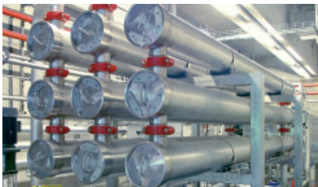
In diesen Röhren findet die Umkehrosmose statt, in denen die Salze aus der Flüssigkeit gefiltert werden. (J.-L. Hersener)
