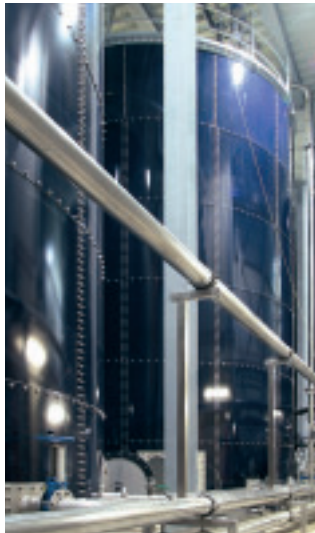
Tanks zum Zwischenlagern und Mischen. (J.-L. Hersener)
