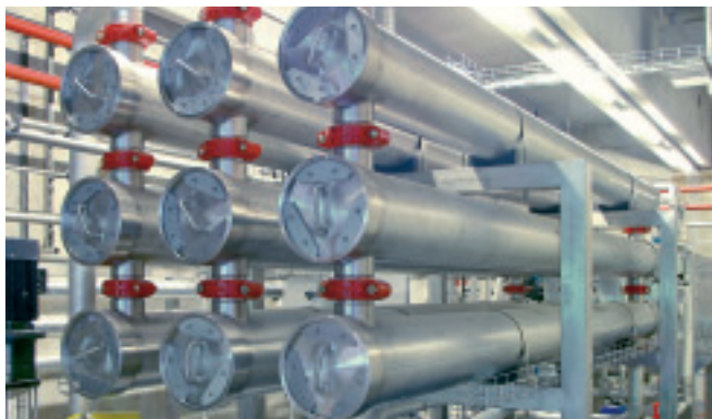
In diesen Röhren findet die Umkehrosmose statt, in denen die Salze aus der Flüssigkeit gefiltert werden. (J.-L. Hersener)
